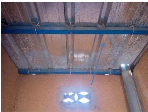
Manque de feutre bitumineux
