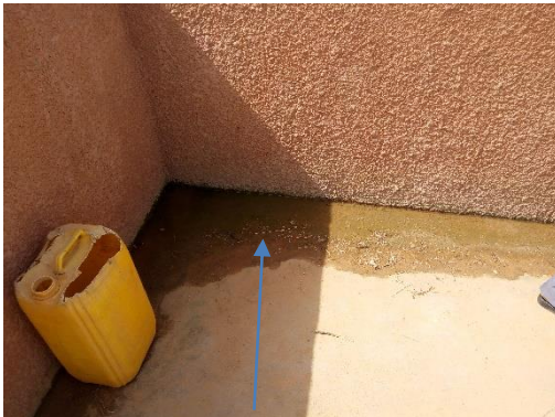
Stagnation des eaux de puisage
