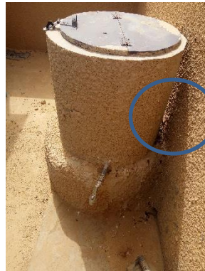
Enduits tyrolienne mal fait
