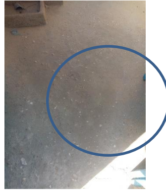
Chape bouchardée dégradée
