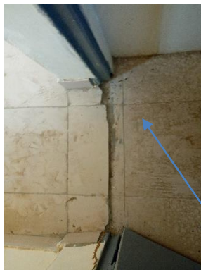
Carreaux mal raccordés
