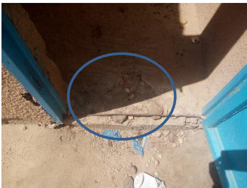
Chape bouchardée dégradée
