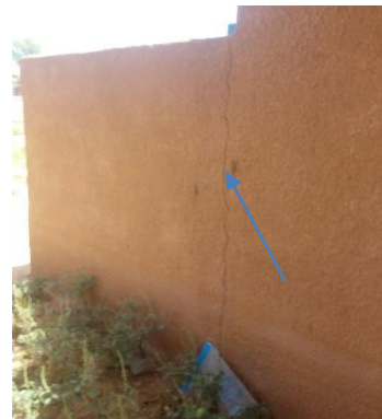
Fissure sur le mur
