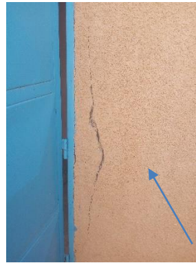
Fissure / détachement imminent de la porte
