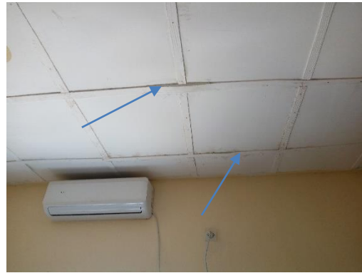
Trace des eaux de pluie (Fuite au niveau de la tôle
