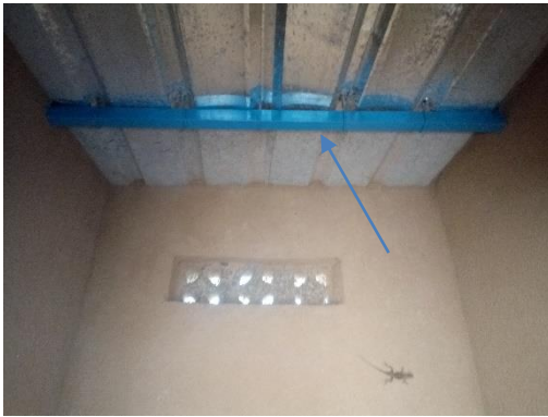
Manque de feutre bitumineux
