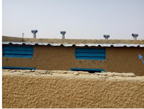
Grille d'aération non conforme au marché
