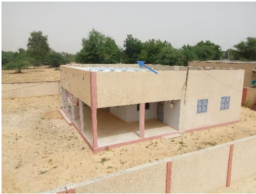
Manque de relevé d'étanchéité
