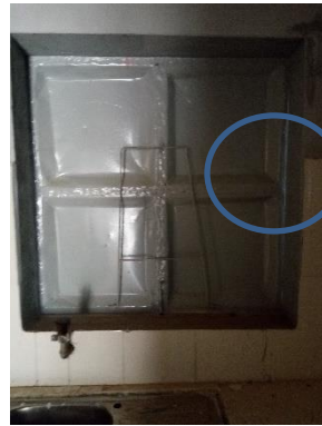
Manque de finition de la fenêtre
