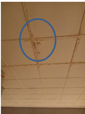
Faux plafond taché
