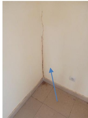
Présence des termites
