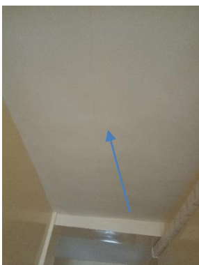
Fissure sous la dalle
