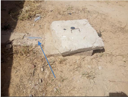
PVC non protégée (dalle détériorée)
