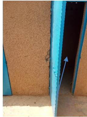
Porte mal fixée
