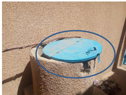
Couvercle de réservoir enlevé
