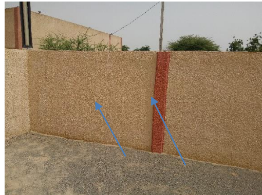
Fissures sur le mur
