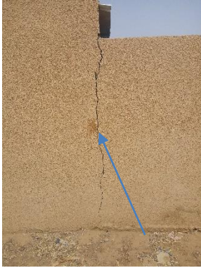
Fissure sur le mur
