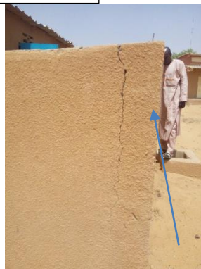
Fissure sur le mur
