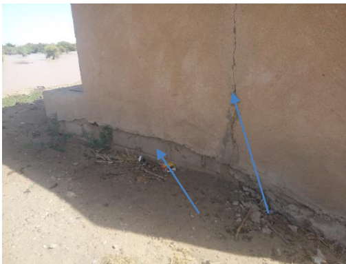
Fissure du mur/ érosion pluviale
