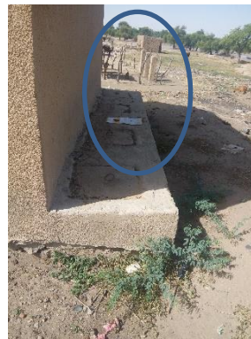
Manque de tuyaux d'aération
