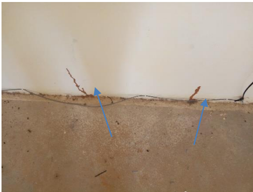
Présence des termites
