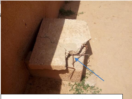
Dalette cassée, fers à béton nus
