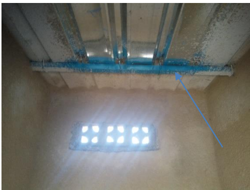
Manque de feutre bitumineux
