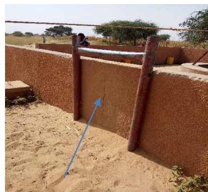
Fissure sur le mur
