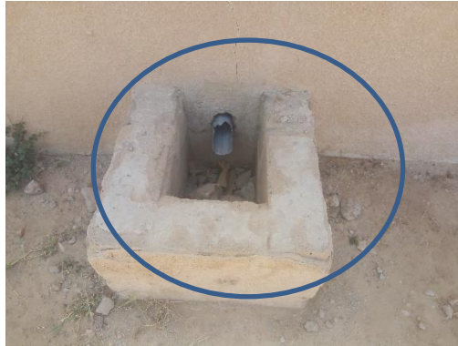
Manque de dalle de couverture
