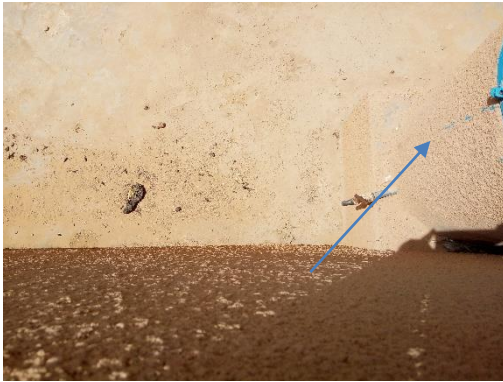
Enduit tyrolien mal fait
