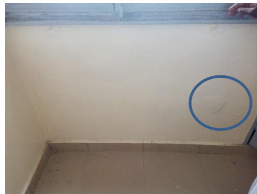
Enduit mal fait
