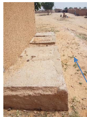
Manque de trappe de visite de la fosse
