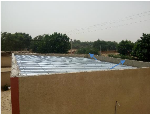
Manque de relevé d'étanchéité
