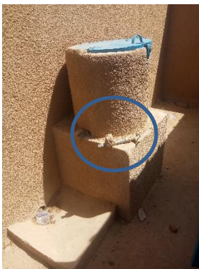
Robinet séparé du réservoir
