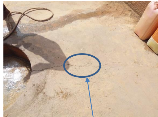
Fissure sur la chape bouchardée
