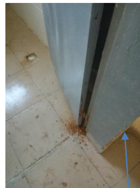
Présence des termites
